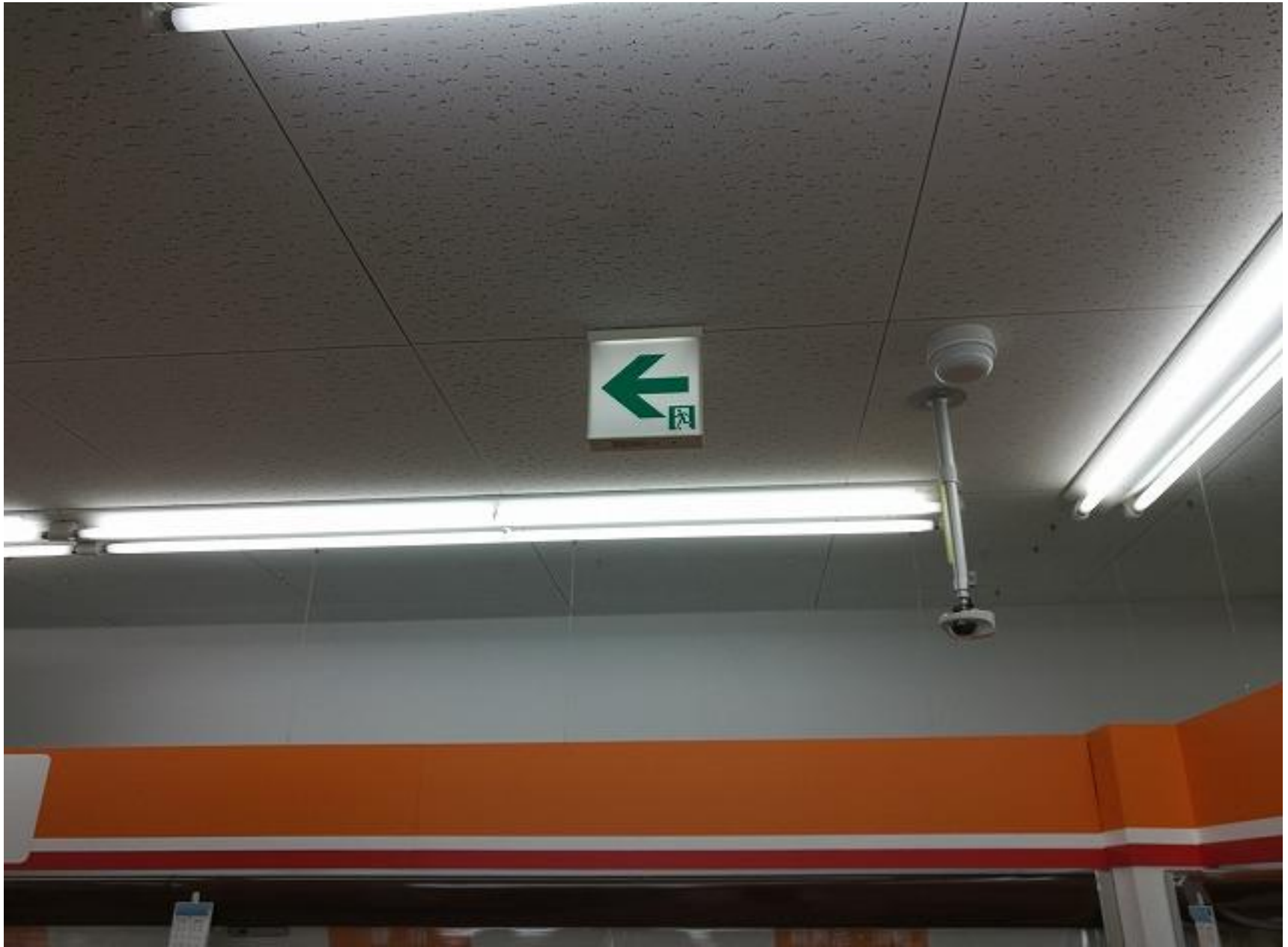
【是正对象施工前】
